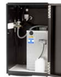
Køleanlæg i underskab
